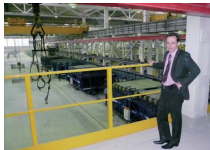
Abb. 10: Der Projektleiter Alexander D. Jaroschenko von DSK Blok freut sich über eine saubere und übersichtliche Installation.
