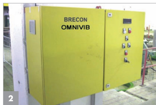
Sistema de control centralizado del sistema Omnivib de instalación fija
