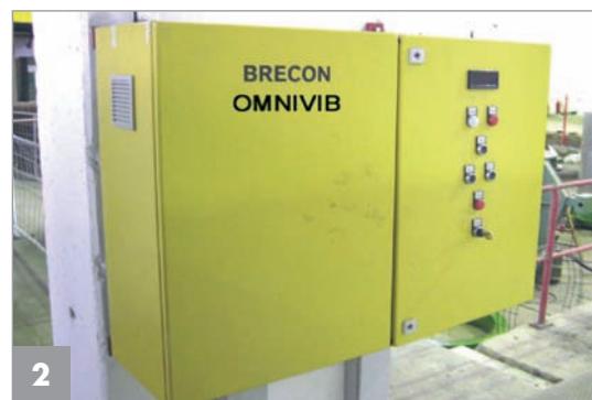
Commande centrale du système fixe Omnivib
