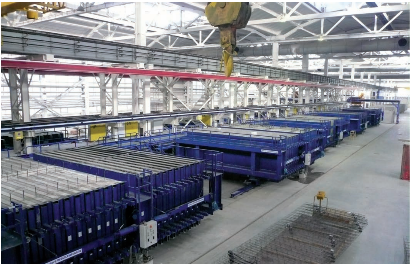
Fig. 1: La técnica de control para la vibración de cinco encofrados en batería con casi 500 vibradores, está instalada en una pasarela a 4m de altura. Todas las cinco unidades de operación pueden sustituirse entre sí sin conmutación (redundancia).
