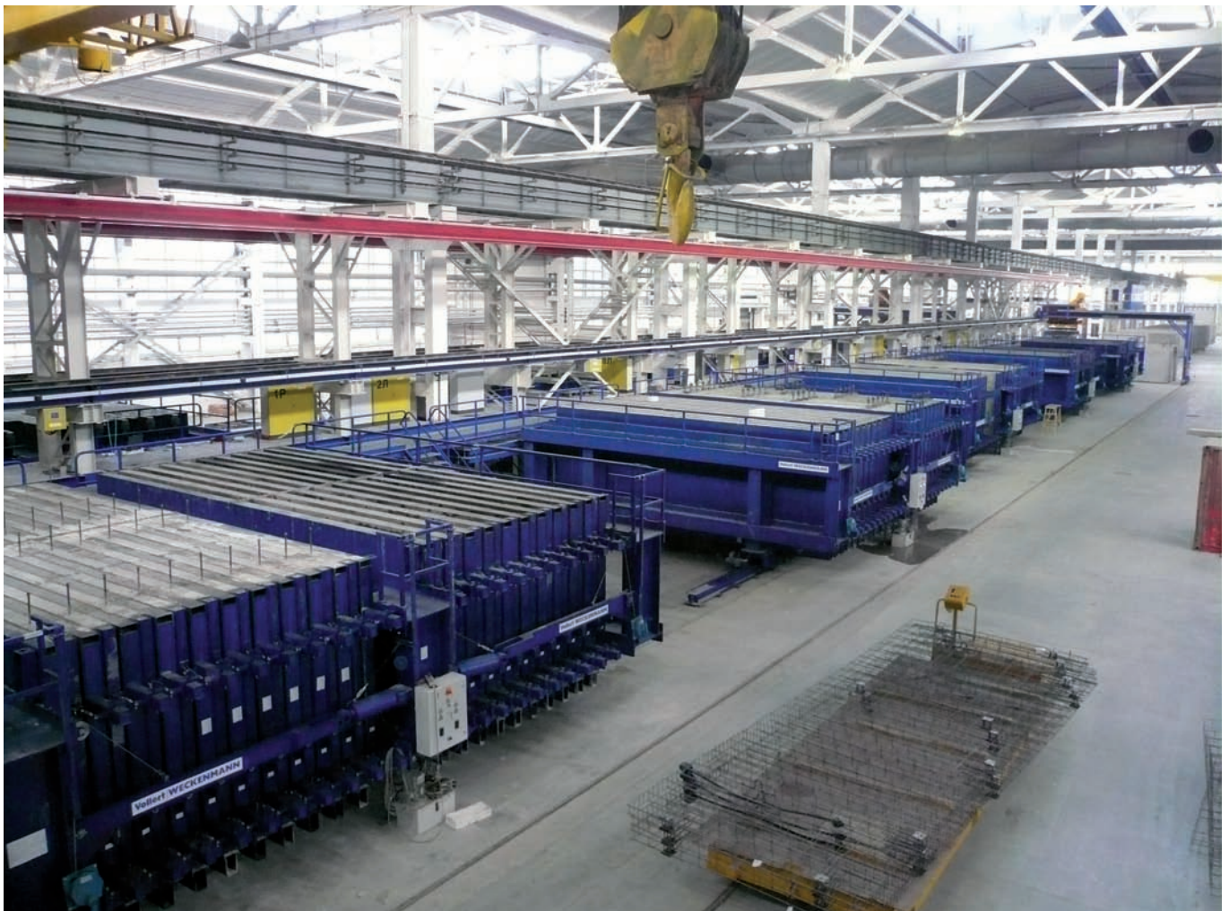
Fig. 1: La technique de commande pour la vibration de cinq batteries coffrantes avec près de 500 vibreurs est installée sur un rail à 4 m de haut. Les cinq unités de contrôle peuvent se remplacer mutuellement sans mise hors service (redondance).
