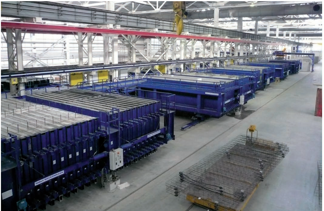
Fig. 1: Il sistema di controllo per la vibrazione di cinque casseforme in serie con quasi 500 vibratori è installato su una ringhiera a 4 m di altezza. Le cinque unità di comando possono sostituirsi reciprocamente senza commutazione (ridondanza).
